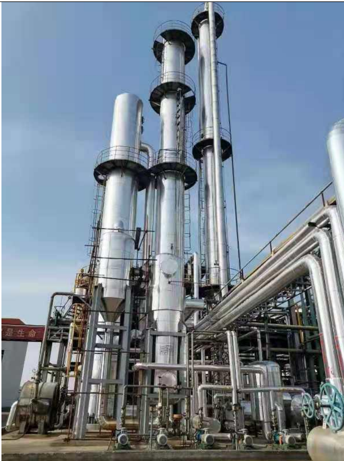
图 4.1-7 5 万吨酒精项目蒸馏工序现场设备图
