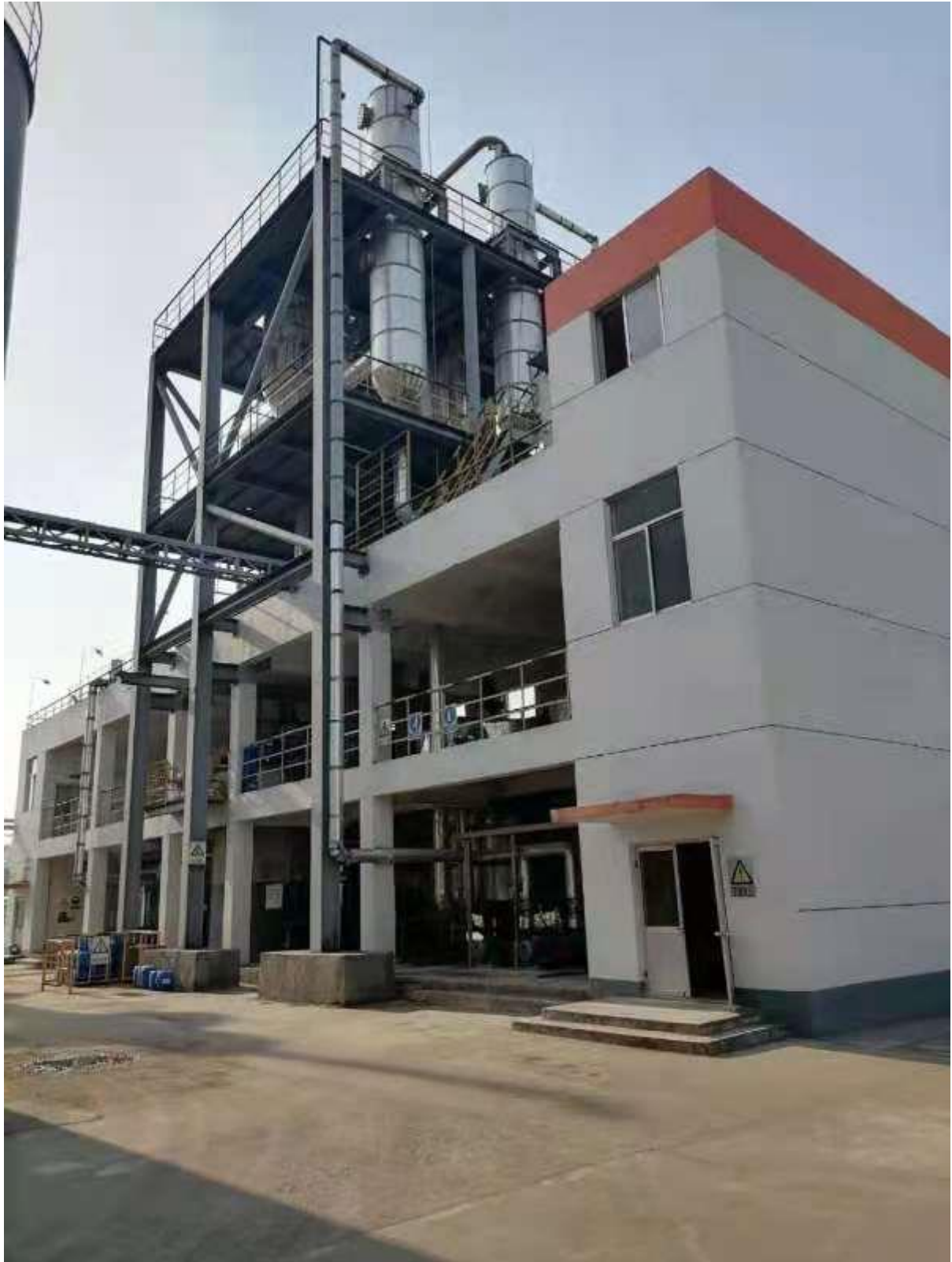
图 4.1-6 5 万吨酒精项目蒸煮糖化现场设备图
