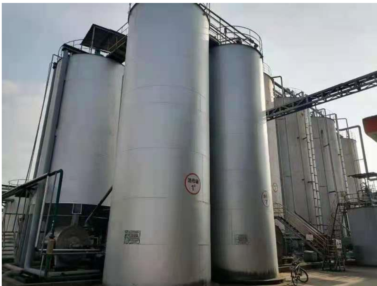
图 4.1-5 5 万吨酒精项目发酵工段现场设备图
