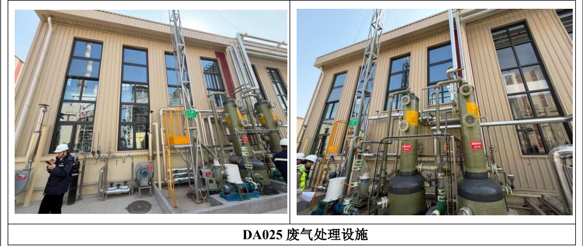
图 3-2 废气处理设施照片
