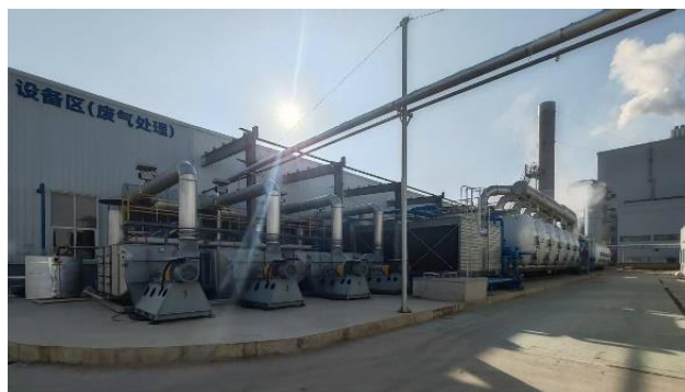
车间一（涂层车间）排气筒（DA002）
