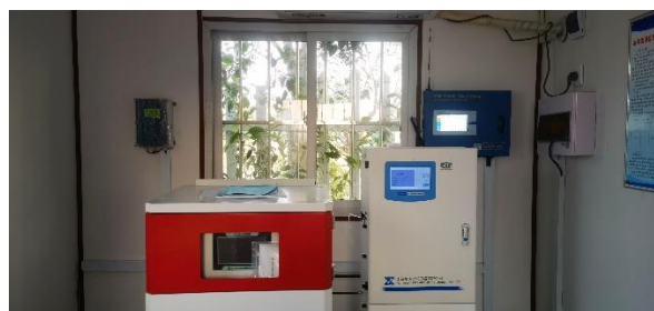
雨水在线监测设施
