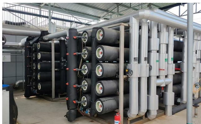
污水站 RO 池
