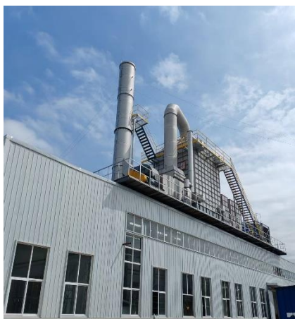
车间三（定型车间）排气筒 (DA001)
