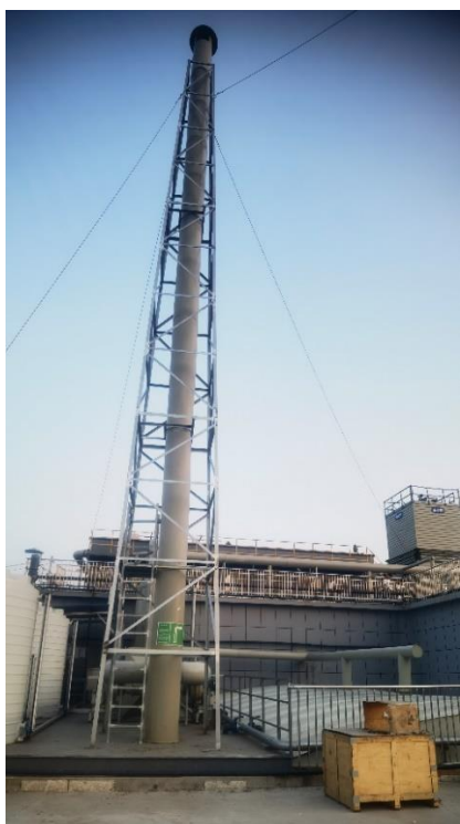
污水站、配胶房、危废库、甲苯储罐 处理设施排气筒（DA003）
