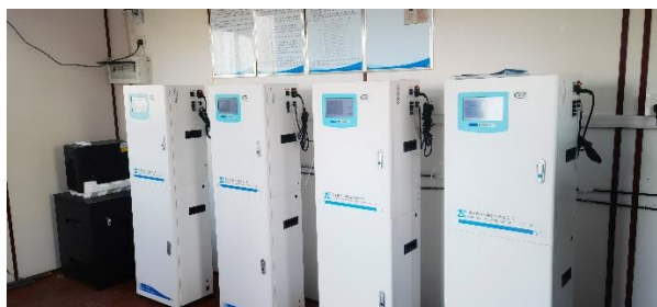
污水在线监测设施
