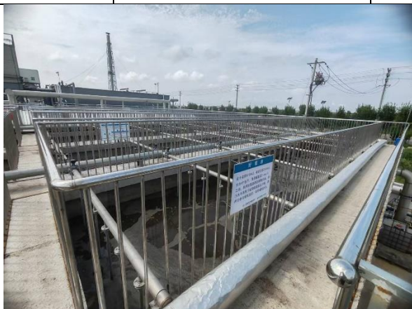
污水站好氧池
