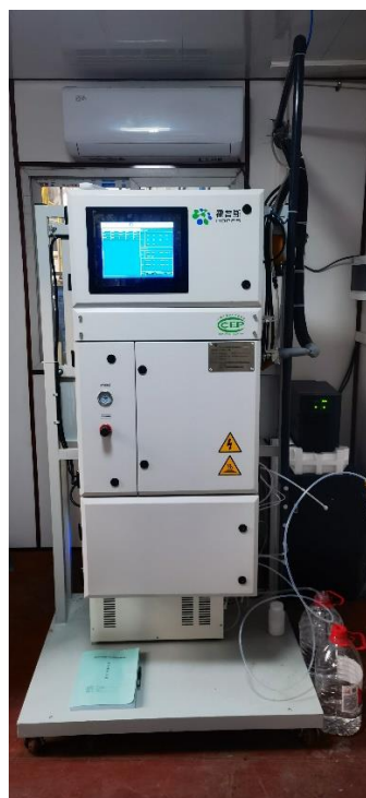
废气非甲烷总烃在线监测设施
