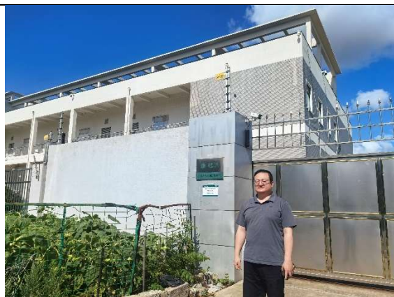
国网新村 110Kv 变电站
