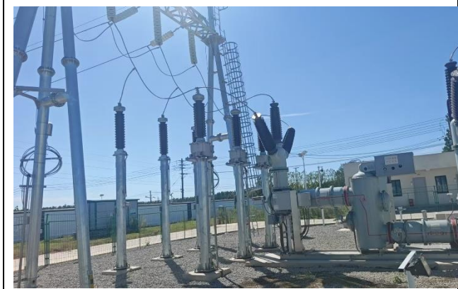
110Kv 配电装置
